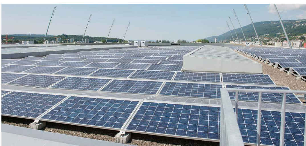
La centrale solaire de la Tissot Arena est la plus grande installation photovoltaïque intégrée dans un stade. A.
