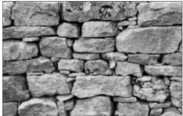
Douanne (objet 4) Rénovation du mur de pierres sèches à Gaicht. Ce magnifique mur est bien visible de la route.
